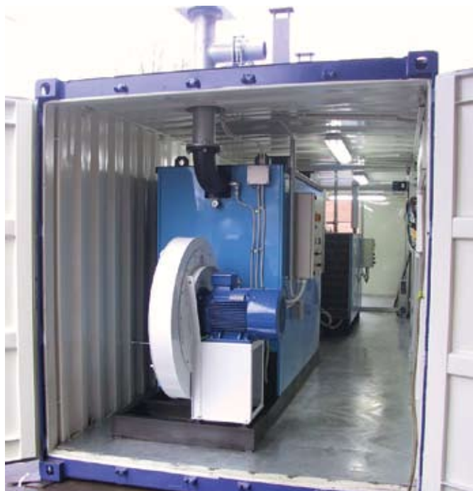
Рис. 5. Вид оборудования при расположении в контейнере
